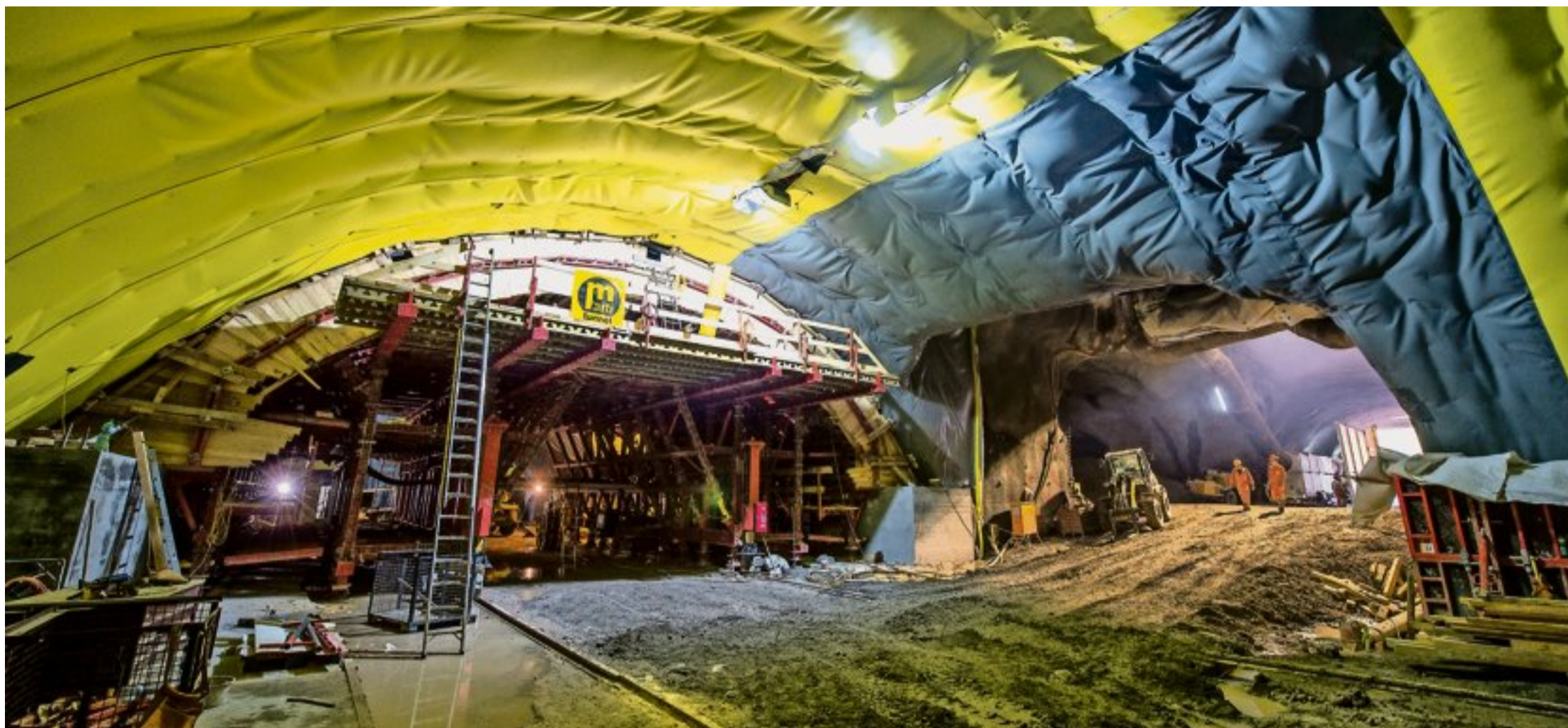
Blick in die eine der beiden Kavernen: Vom massiven Schalungsgerüst aus werden die Schalungs- und Betonarbeiten ausgeführt. Im Bild rechts ist der künftige Einfahrtsbereich von der Burgstrasse her zu sehen.
