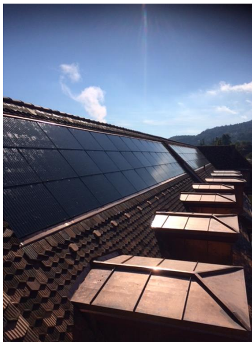
Photovoltaikanlage auf dem Dach
